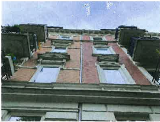
Bauteillfuge zw. Haus 110 und 112
