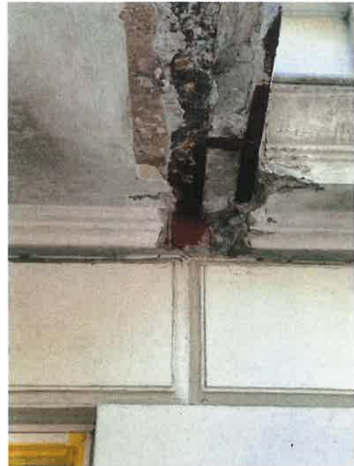
Balkonuntersicht mit seilt. Verwitterung
