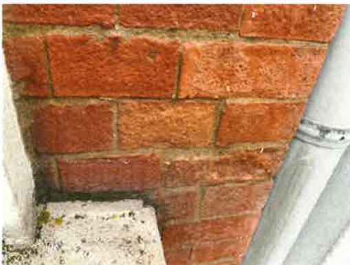
Fassadendetail mit zerstörter Brennhaut der Ziegel
