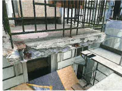
Balkonplatte mit freigestemten Trägern
