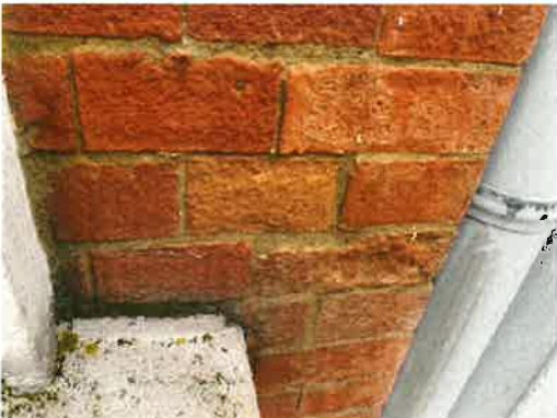
Fassadendetail mit zerstörter Brennhaut der Ziegel
