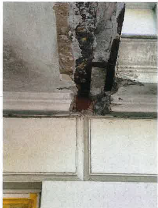
Balkonuntersicht mit seilt. Verwitterung
