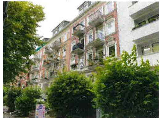
Fassadenausschn. mit Nachbar 108 (WDVS)
