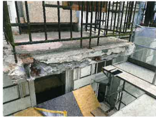
Balkonplatte mit freigestemmten Trägern
