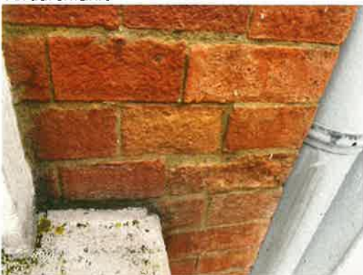
Fassadendetail mit zerstörter Brennhaut der Ziegel
