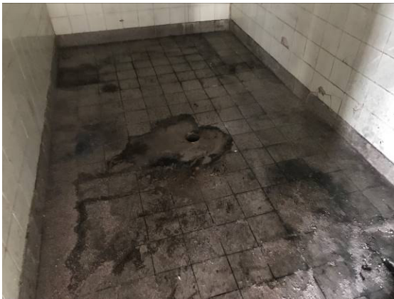
Foto 21: BK3 – FuBo Kühlraum – EG – Haus 1
