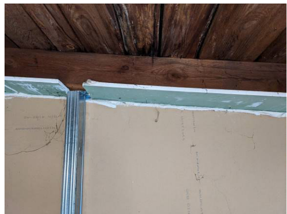
Foto 10: P4 - Spachtelmasse GK-Wand - Haus 1 - 1.OG
