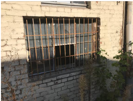
Foto 13: P7 - Fensterkitt - Haus 1 - EG
