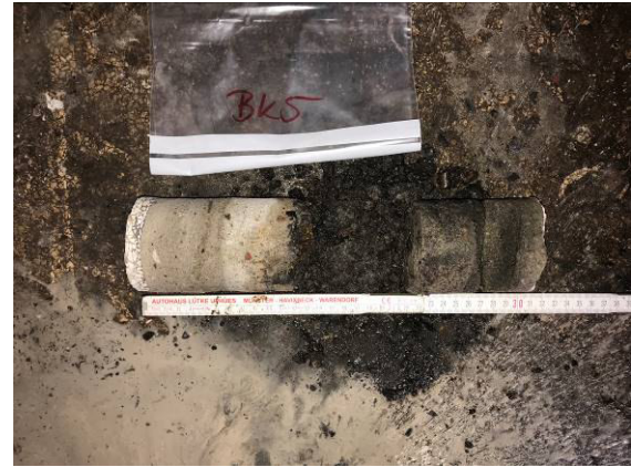
Foto 26: Fuge (P1.2) und Fliesenbett (P2.2) Damen WC EG, Raum H0 14h
