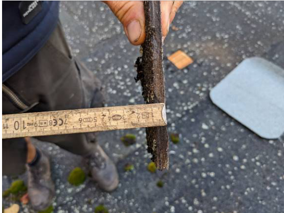
Foto 13: P19 – DÖ3 - Dachabdichtung - Haus 2/Garage
